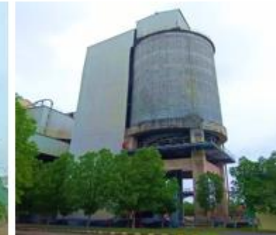
Fly Ash Silo
